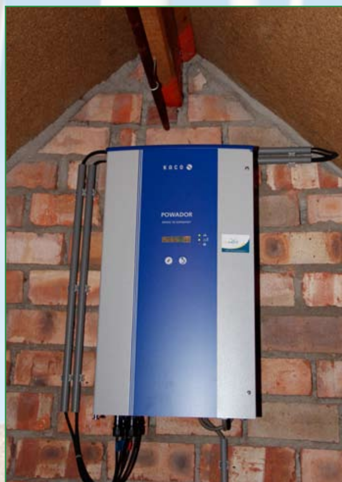
Omvormer. Bij Broeren zit de omvormer in de nok van de woning, vlak bij de zonnepanelen. "De omvormer maakt 30 procent uit van de investering. Dat moet je niet onderschatten." (foto: De Maas Driehoek)
