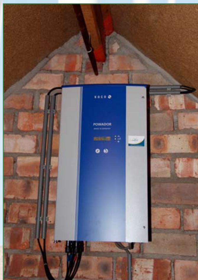
Omvormer. Bij Broeren zit de omvormer in de nok van de woning, vlak bij de zonnepanelen. "De omvormer maakt 30 procent uit van de investering. Dat moet je niet onderschatten." (foto: De Maas Driehoek)
